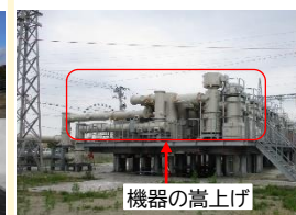
機器の高上げによる変電機器の冠水対策
