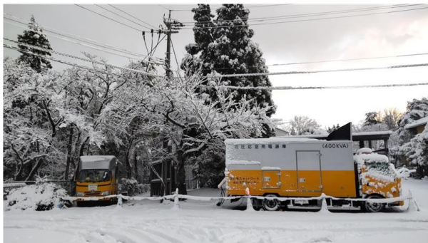
高圧発電機車による応急送電
