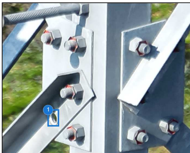
● ボルト脱落穴の検出
